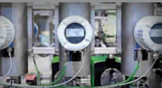
Massiccio del gruppo iniezione dosaggi
