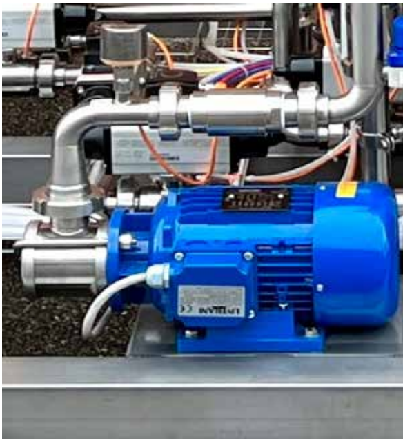
输送泵 (离子交换、再生、冲洗)
