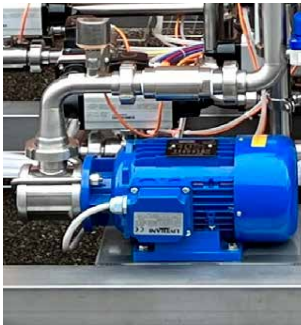
BOMBA DE ALIMENTAÇÃO (PERMUTA, REGENERAÇÃO, ENXAGUAMENTO)
