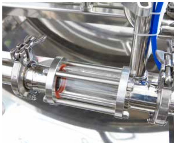
MIRILLA EN TUBERÍA A LA SALIDA*
