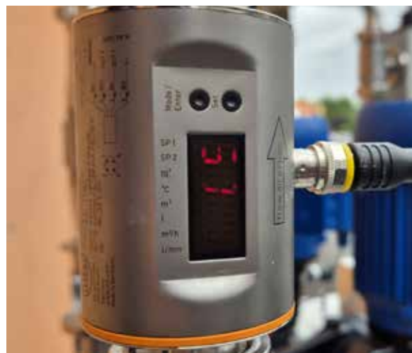
1 MEDIDOR DE VAZÃO DE BOMBA/PRODUTO
