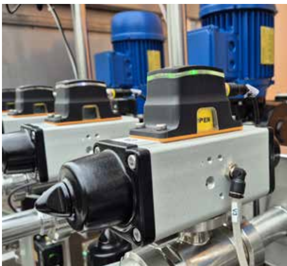
14 VÁLVULAS PNEUMÁTICAS completas com atuador e sensor de proximidade
