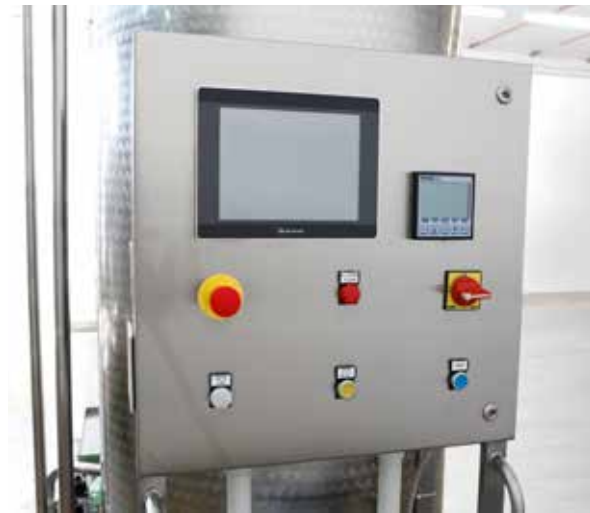
QUADRO ELETTRICO CON pH-METRO
